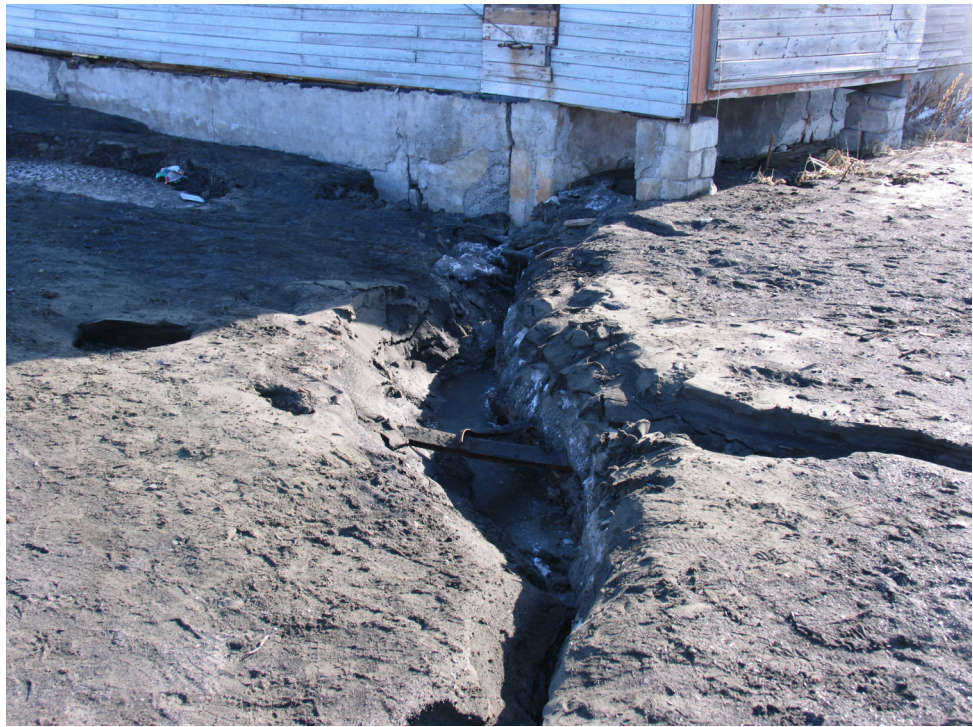
Рис. 1.9. Деформация ленточного фундамента в зоне трещины.
