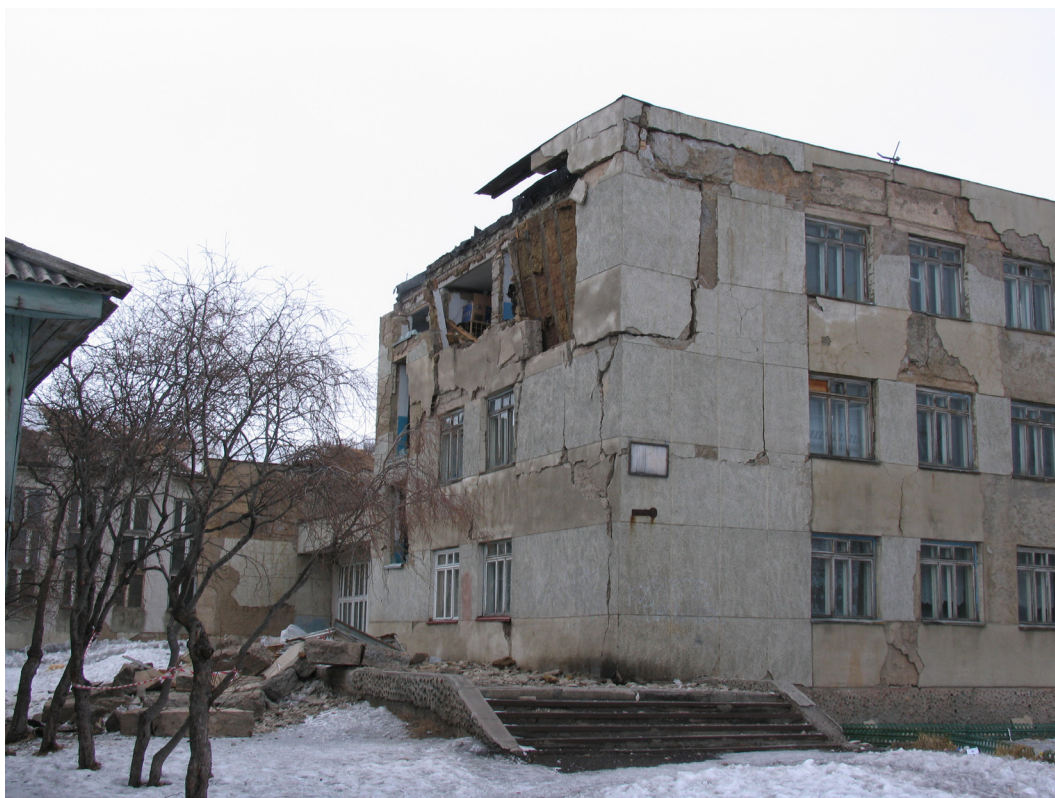
Рис. 1.7. Разрушение школы в пос. Тилички.
