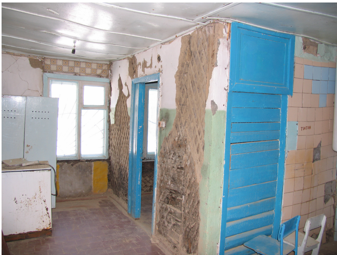
Рис. 1.4. Разрушения в здании детского сада в с. Хаилино.
