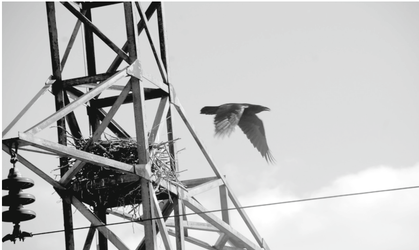
Рис. 1. На этой металлической опоре ЛЭП вблизи г. Елизово ворон Corvus corax гнездится вот уже 15 лет (12 апреля 2022 г., фото автора)
